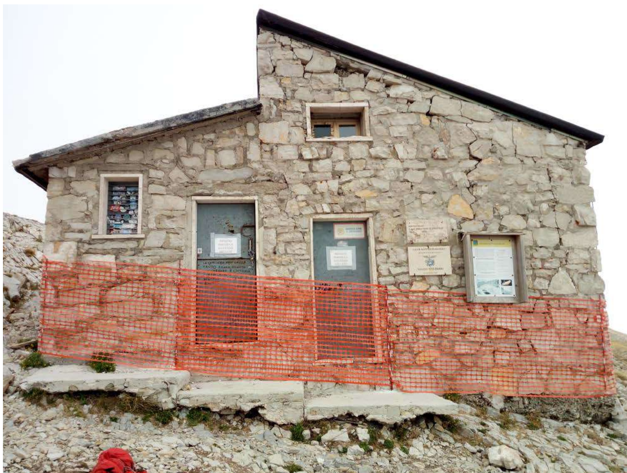
Lo Zilioli "fasciato" con rete di cantiere per segnalarne l'inagibilità.
